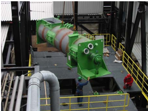
Installation eines 10m 3 Sonderabfallmischers
